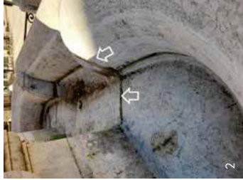
2. Le frecce indicano i residui di silicone, utilizzato in pregressi interventi manutentivi.
